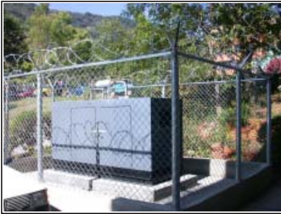
Nuevas Plantas eléctricas.
